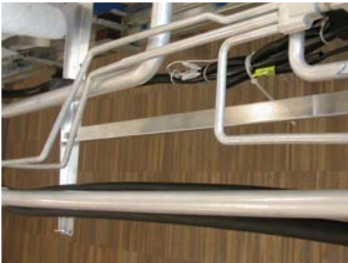
Kältemittelverrohrung aus hochwertigem Aluminium
